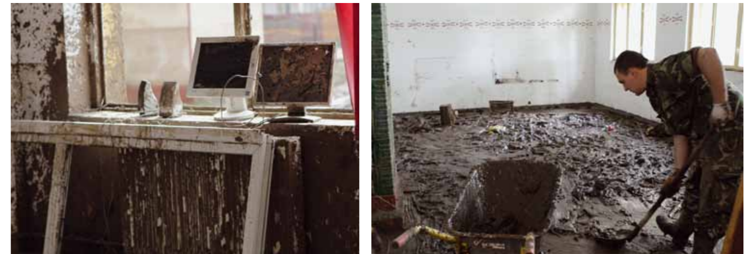
Lucrări de renovare și reamenajare la Școala Generală din Comuna Costache Negri, după inundațiile din octombrie 2013
